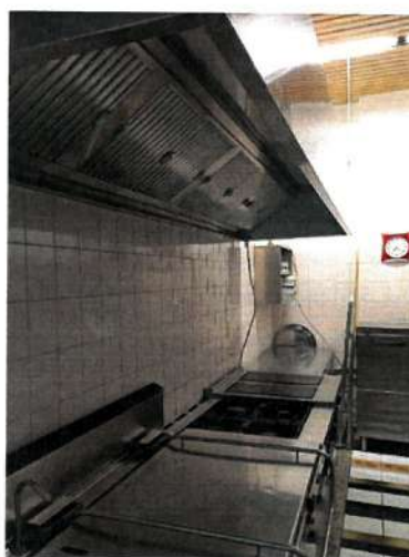
Slika 68 Projekti GDCK Zaprešić, Zamjena sustava ventilacije u pučkoj kuhinji GDCK Zaprešić
